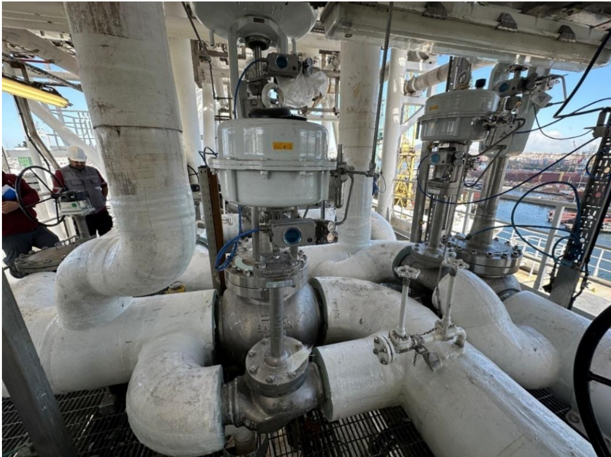
Slika 4. Ugrađeni novi regulacijski ventili na napojnoj liniji ispred rekondenzera na FSRU brodu Izvor: LNG Hrvatska
